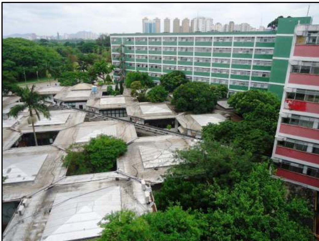
Espaços entre-blocos ocupados por novas construções. Havia que se evitar a convivência entre moradores (B)
